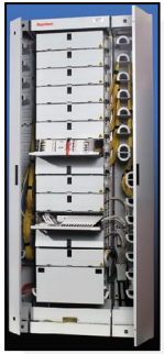
Optical Distribution Frame (ODF)
